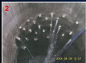
25公尺深 集水井
