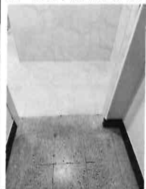
7. 新設加長型蹲式馬桶配件全及大捲筒衛生紙架及廁間增加置物板(25*25cm 半圓)
