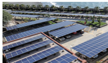
地面型 海工館停車場172kWp
