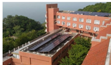
屋頂型-電資111kWp、文學院156kWp 、藝術68kWp、海資館88kWp、國研52kWp 、活動中心76kWp、行政25kWp
