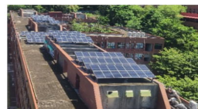
屋頂型 理工大樓56kWp、國研大樓30kWp
