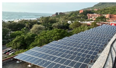
屋頂型 社管大樓154kWp
