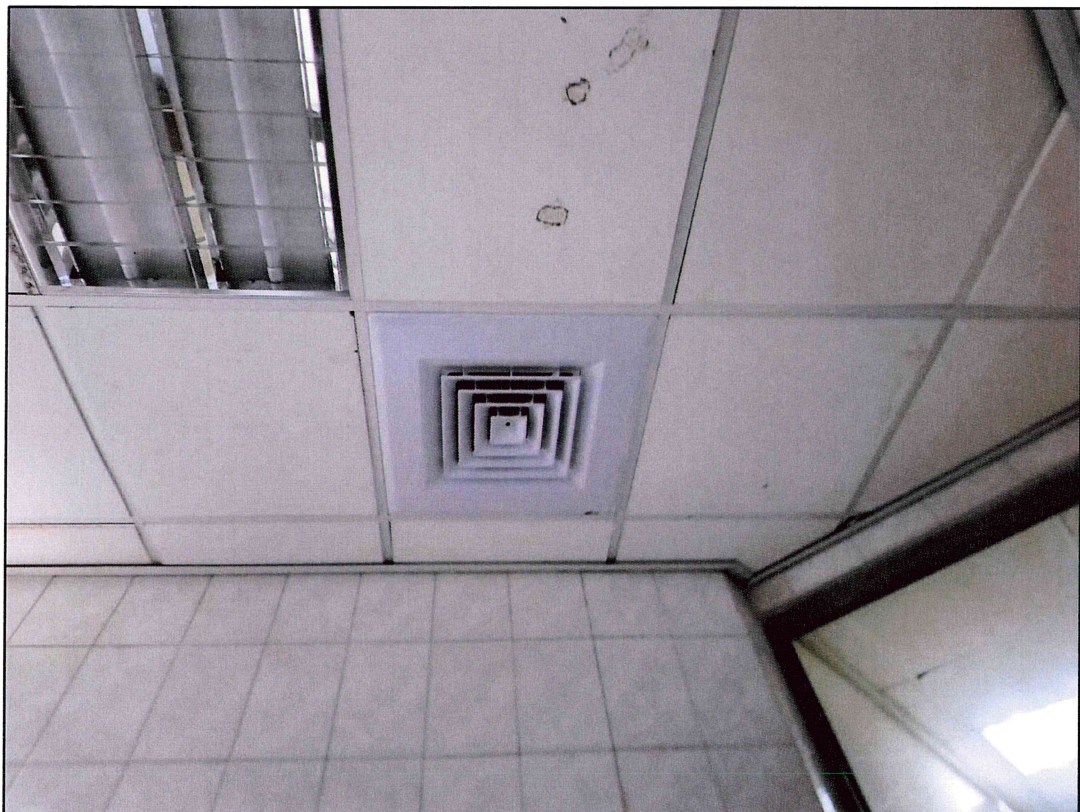
照片(6)、二、文學院藝術大樓 2F 西側無障礙兼性別友善廁所輕鋼架負 壓式排風扇
