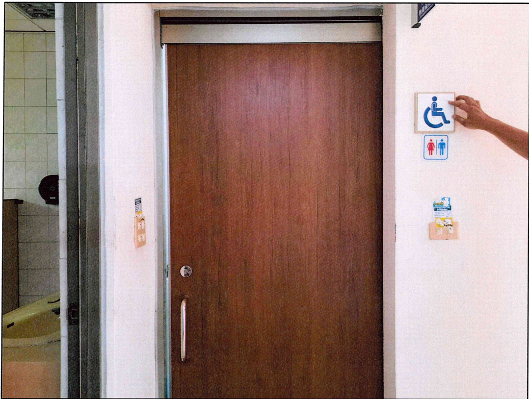
照片(7)、文學院藝術大樓 3F 東側無障礙兼性別友善廁所無障礙廁所橫拉門(含五金配件)
