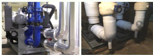
逸仙館冰水主機及區域泵、行政大樓區域泵 體育館冰水主機、圖資大樓冰水主機及冷卻水塔
