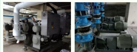
活動中心冰水主機及周邊設備
