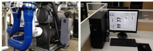
電資大樓冰水主機及周邊設備
